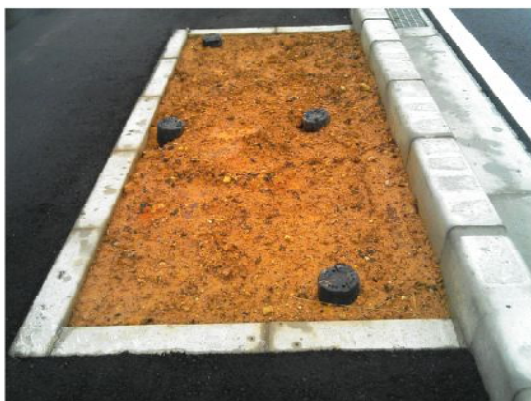
酸素管設置状況
